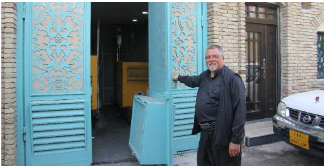
Generátory elektrickej energie pre centrum zakúpené vďaka podpore Slovenskej katolíckej charity
